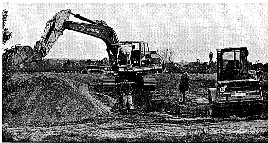
Eifrig wird an der Erschließung von Bauland in der Samtgemeinde Uchte gearbeitet. Foto: Hans-Ulrich Giesecking
