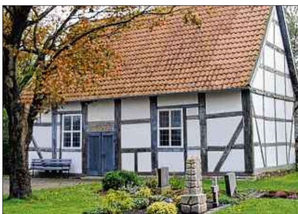
Nach Ansicht der Fachleute muss die Schlüsselburger Fachwerk-Friedhofskapelle saniert werden.
